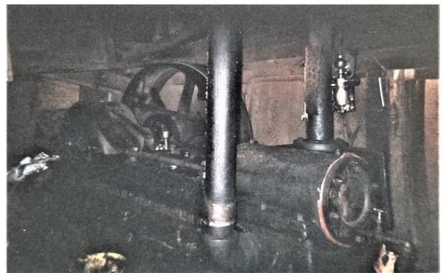
Chaudière de moulin à scie, moulin à scie à vapeur de Frampton, Beauce. Crédit photo : Gérald Beaumont
